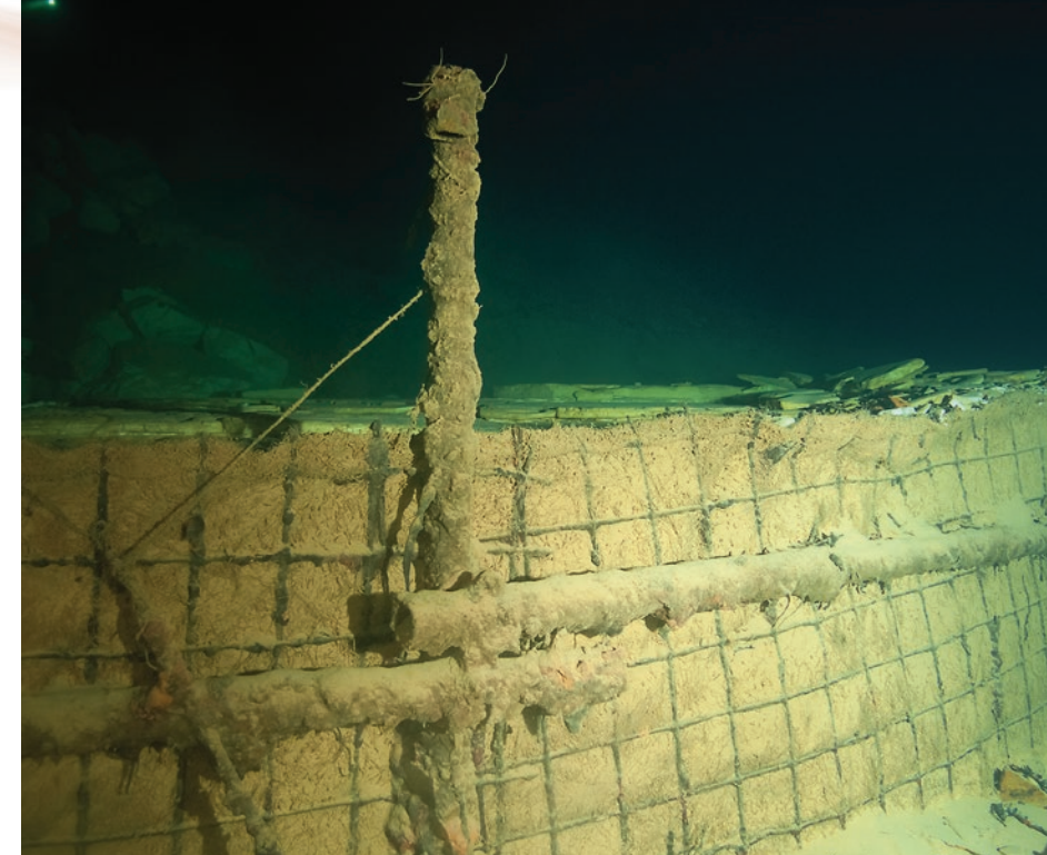
Le plongeur souterrain est déconcerté par le barrage vieillissant et toutes ces ferrailles rouillées ou désagrégées.
